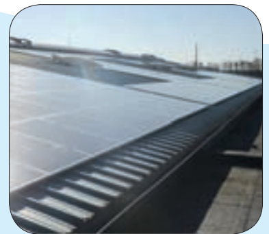
Die Module der Anlage bedecken beinahe das gesamte Dach
