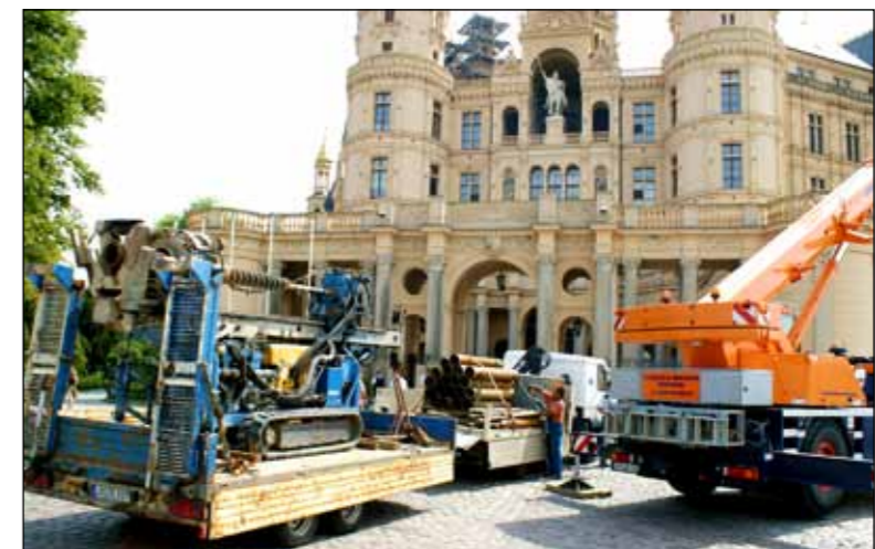
Um das Schweriner Schloss mit Fernwärme zu versorgen, werden die Leitungen mit Hilfe einer speziellen Bohrtechnik direkt unter dem Burgsee verlegt Foto: Stadtwerke
